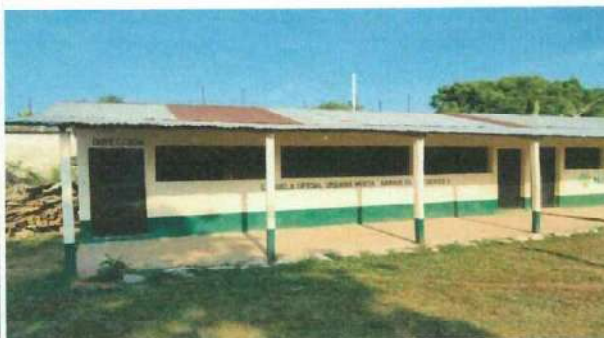
Foto 4: se cambiarán dos puertas que estan en mal estado.
