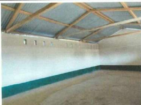
Foto 3: se levantará el piso y se le colocara piso cerámico a dos aulas y a la dirección, ya que en temporada de lluvia se filtra el agua.
